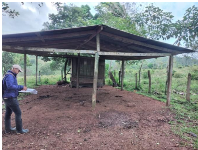
Figura 20. Galeras en los sistemas de alimentación donde se observan en mal estado (Rodríguez, 2021).
