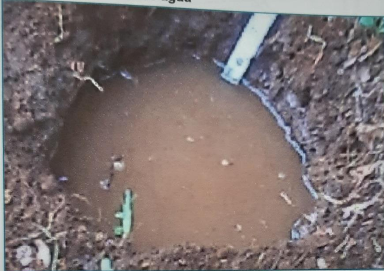
Foto 3. Infiltración de agua
