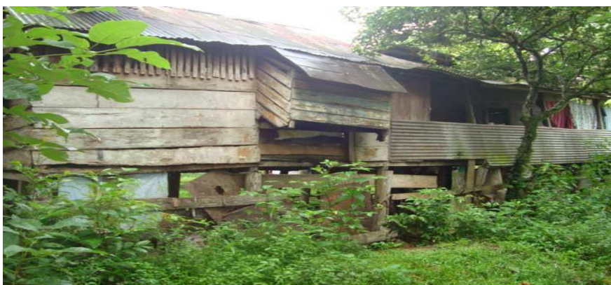
Foto tomada por Yadeysy Zelaya el día 05 de septiembre 2010, donde se puede observar el mal estado de las viviendas del barrio Rigoberto López.
